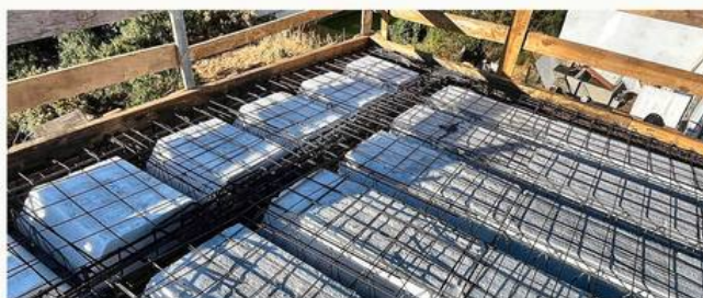
Perímetro con barandilla y rodapié en todo el borde de forjado.
